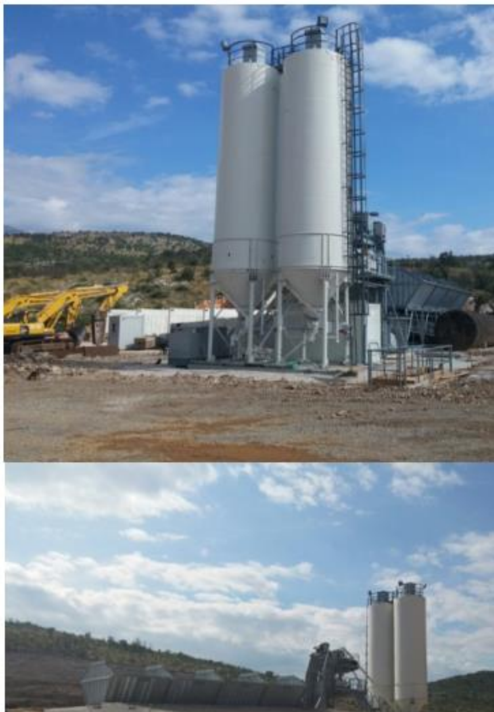
Slika 3.1. Izgled predmetnog postrojenja Liebherr Compactmix 1.0 – silosi, mješalica i manipulativni plato.
