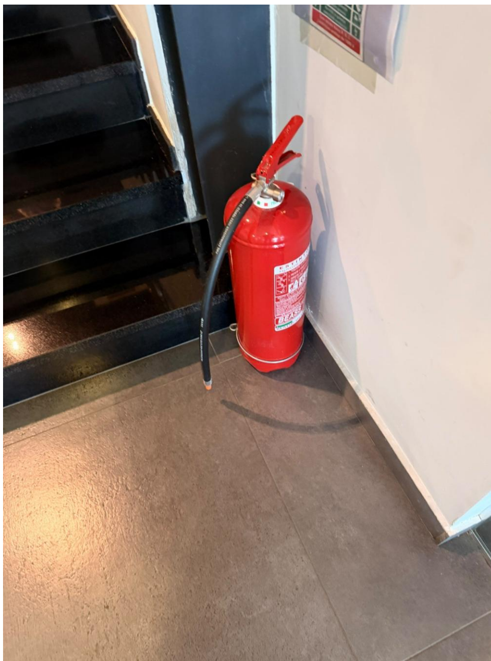
Fotografija 5. Element protivpožarne zaštite u objektu - prenosni aparat za gašenje požara.
