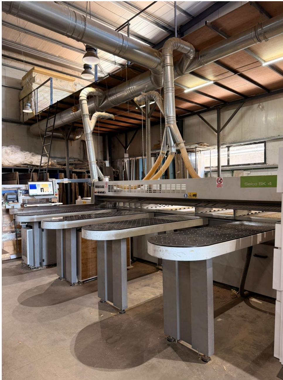
Fotografija 4. Dio proizvodne linije za obradu pločastih/drvnih materijala sa priključenim odsisnim sistemom.
