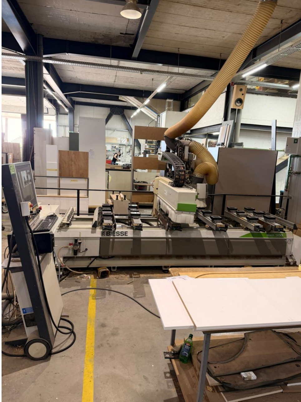
Fotografija 1. Dio proizvodnog prostora sa instaliranom mašinskom opremom i lokalnim odsisnim vodovima.
