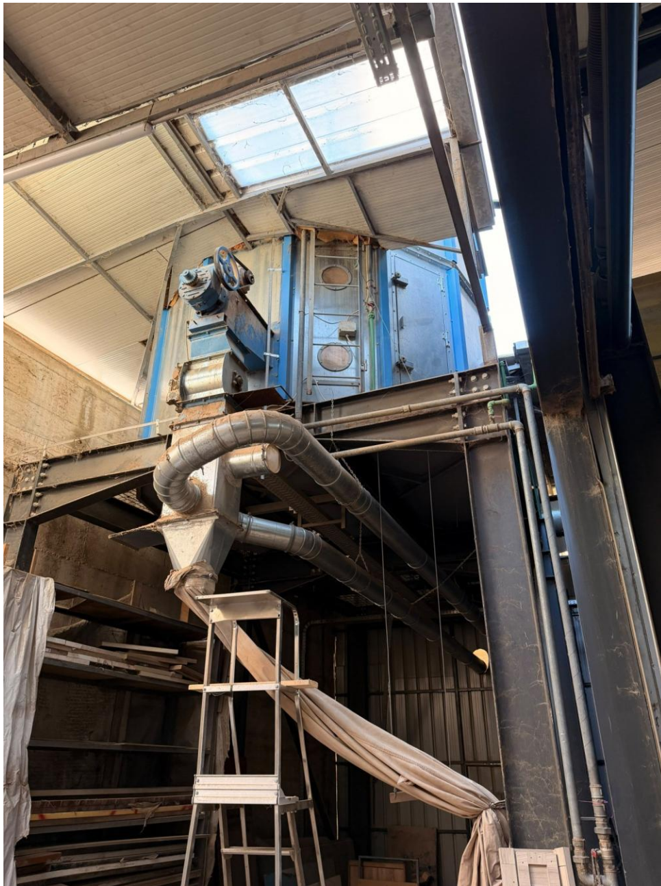
Fotografija 2. Centralni dio sistema aspiracije/otprašivanja i cjevovodi za odvođenje prašine.
