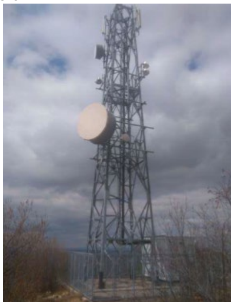
Slika 2.2. Izgled opreme na antenskom stubu
