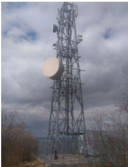
Slika 2.2. Izgled opreme na antenskom stubu
