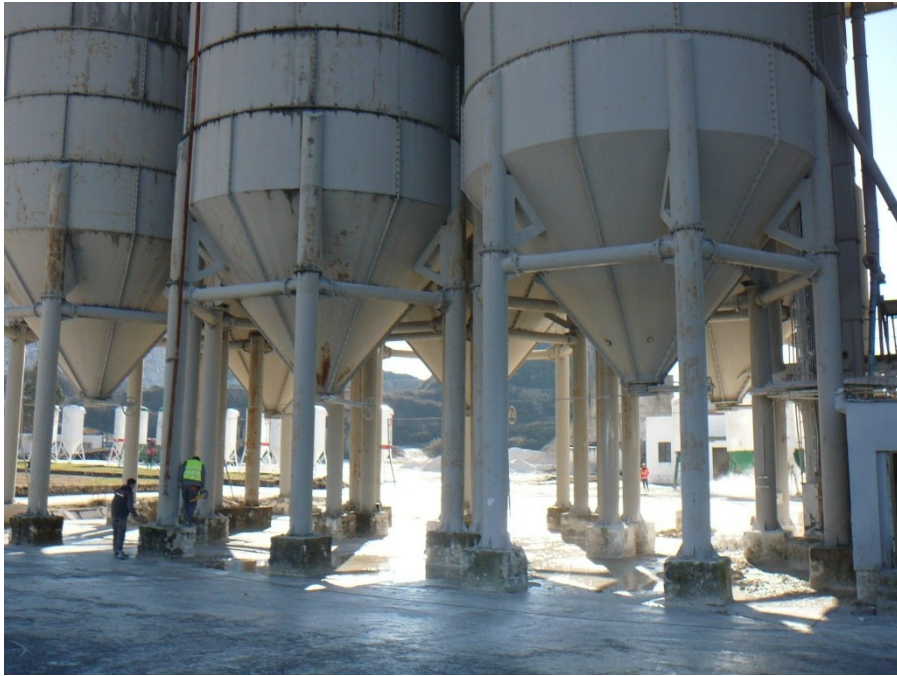
Slika 18. Izgled silosa u kojima se doprema granulat 0-4 mm
