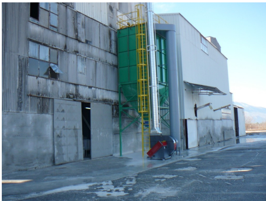
Slika 23. Filterski sistem instaliran u sklopu pogona za proizvodnju praškastih materijala (mašinskog maltera i ljepila)
