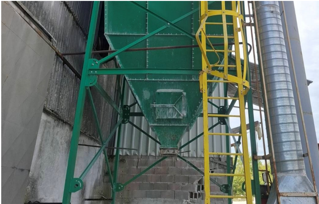
Slika 34. Otvor na dnu sabirnog korita silosa na koji se kači jumbo vreća
