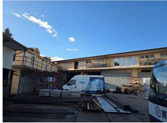
Slika 5. Prikaz objekata broj 2 (broj zgrade 1 na k.p.3789/1), 3 (broj zgrade 2 na k.p.3789/1) i 4 (broj zgrade 3 na k.p.3789/1) koji se uklanjaju.
