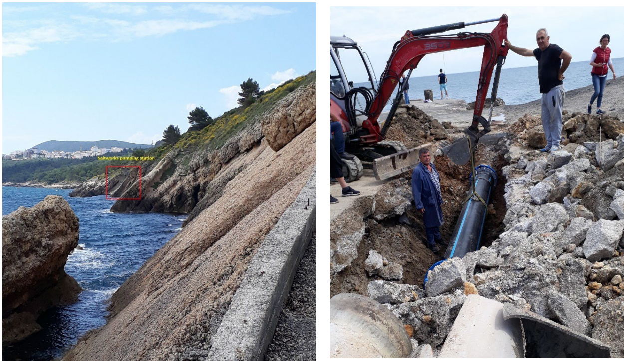
Slika 2-29: Infrastruktura na rtu Đeran: pumpna stanica u solani i glavni kanalizacioni kolektor
