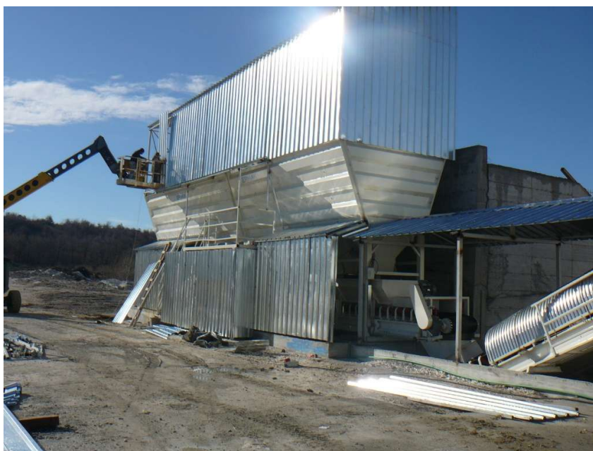
Slika 25. Bunker za smještaj drobljenog materijala granulacije 0-4 mm
