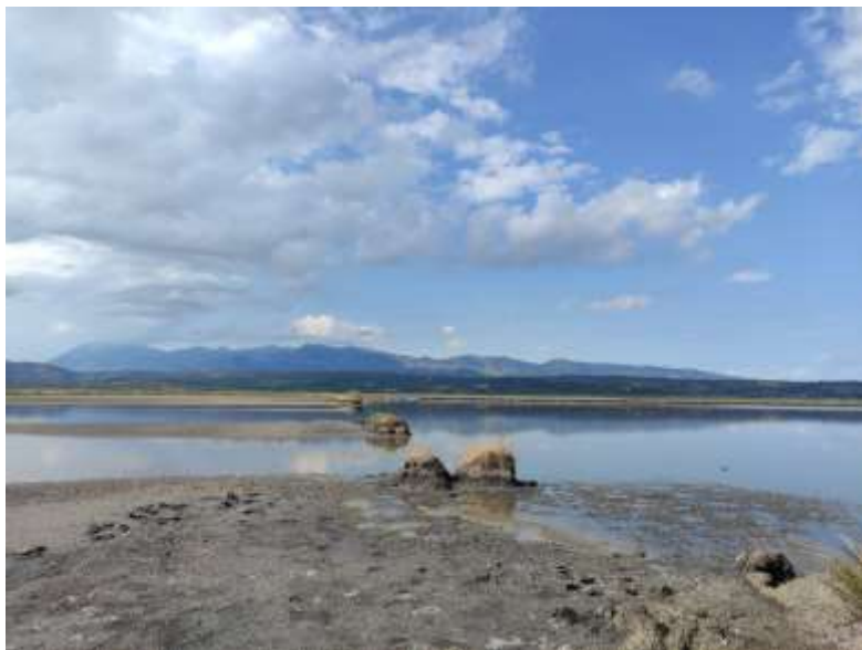
Slika 2. Jedan od urušenih nasipa između bazena isparenja koji je neophodno sanirati
