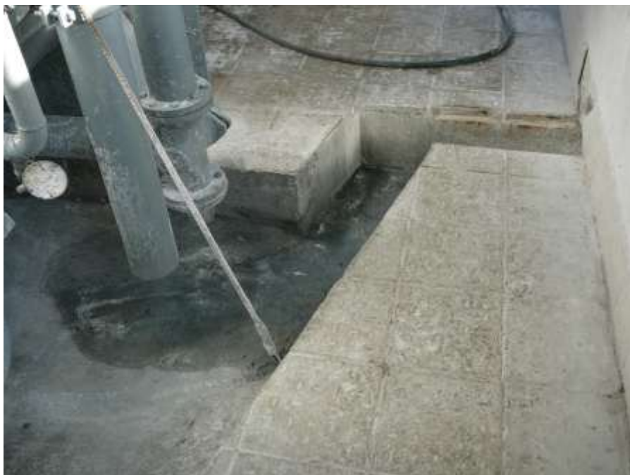
Slika 5. Kanal za ispuštanje krečnog mulja iz razvijča
